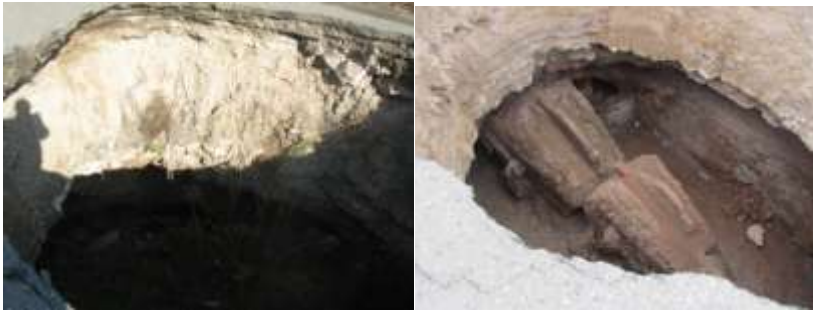
Şəkil 6. Qorb karvansaranın örtük konstruksiyası dağılmışdır.
